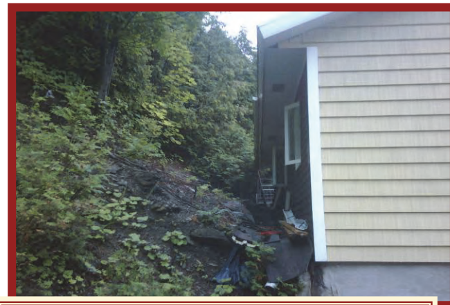
Éboulis rocheux Rue St-Laurent (Juillet 2011)
